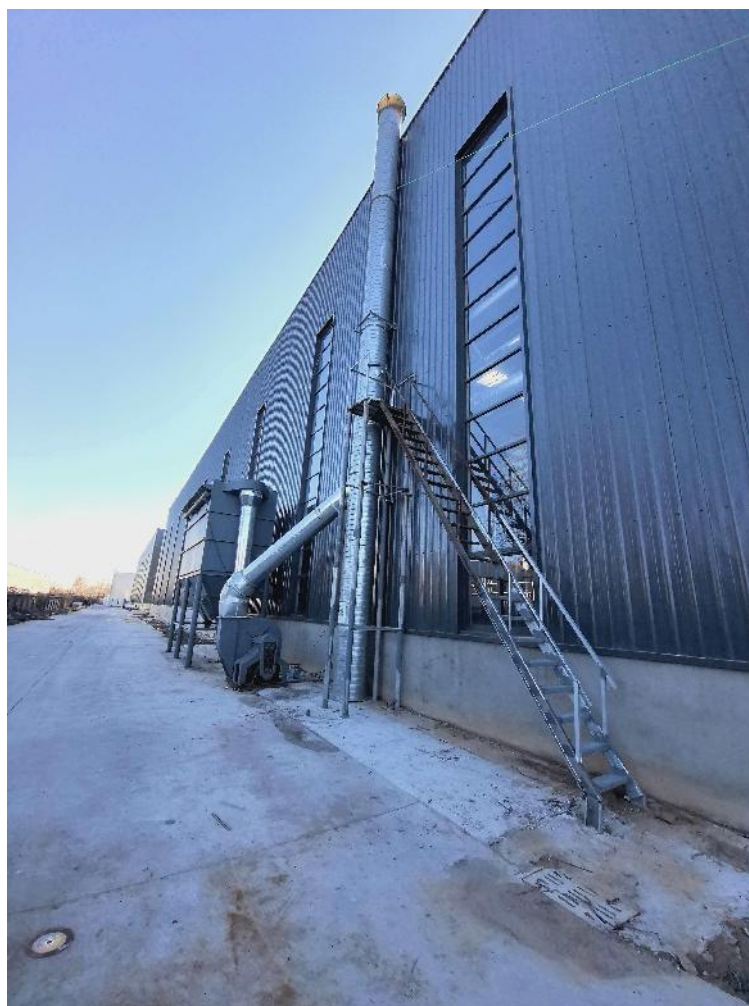
图 3-5 除尘器、排气筒及采样平台
