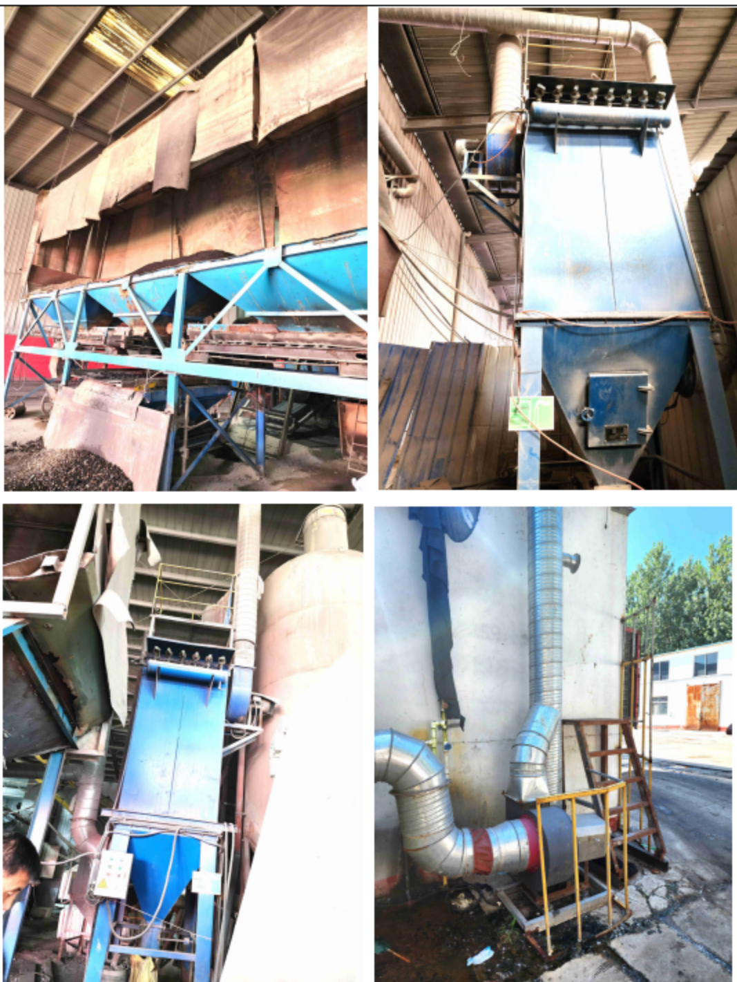
图 3-1 上料集气罩、除尘器和排气筒
