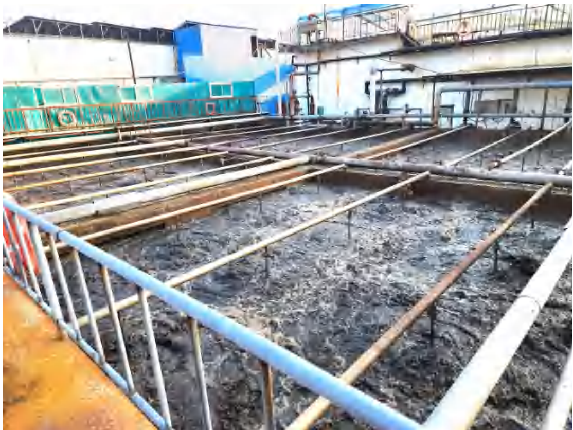
图 3-1 项目厂区污水处理站
