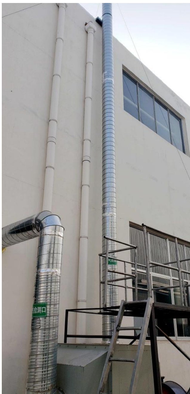
图 3-3 15m 高排气筒 (DA002) 和采样平台
