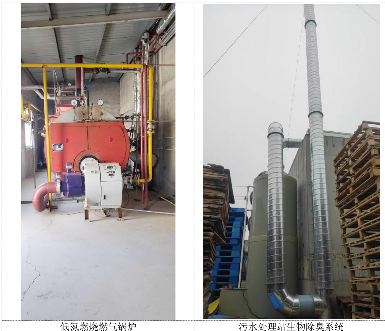
图 4-1 废气处理设施
