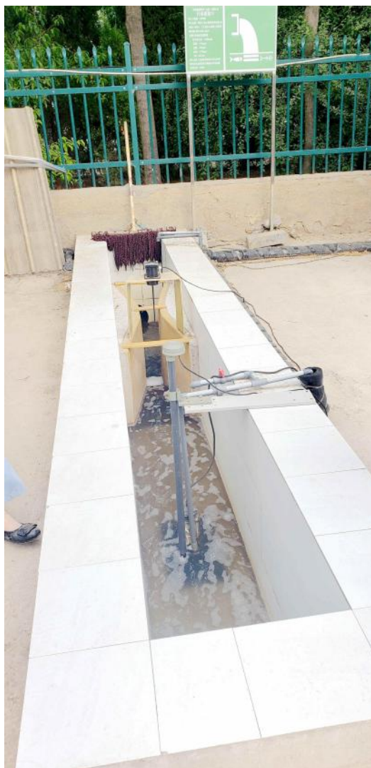
图 4-4 废水在线监测装置
