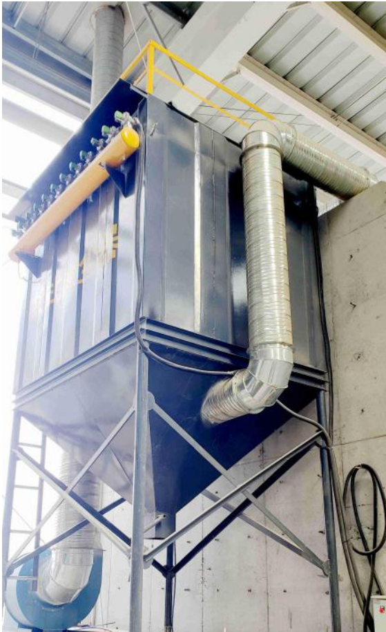
图 3-4 2#车间布袋除尘器
