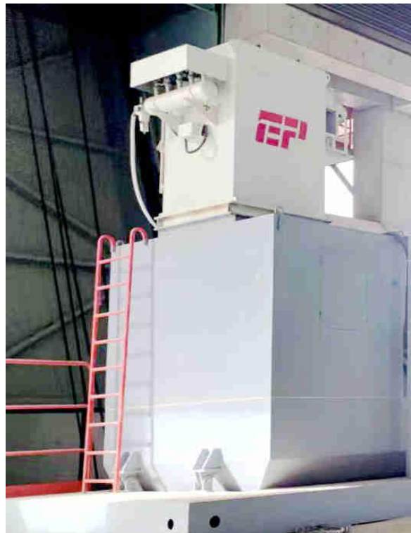
图 3-5 提升机脉冲除尘器位于密闭料仓内
