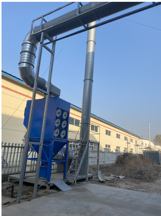
打磨、焊接废气处理设施
