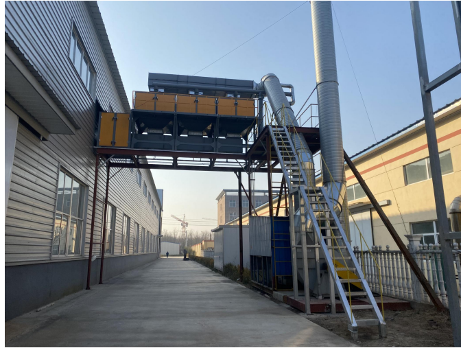
喷漆废气处理设施
