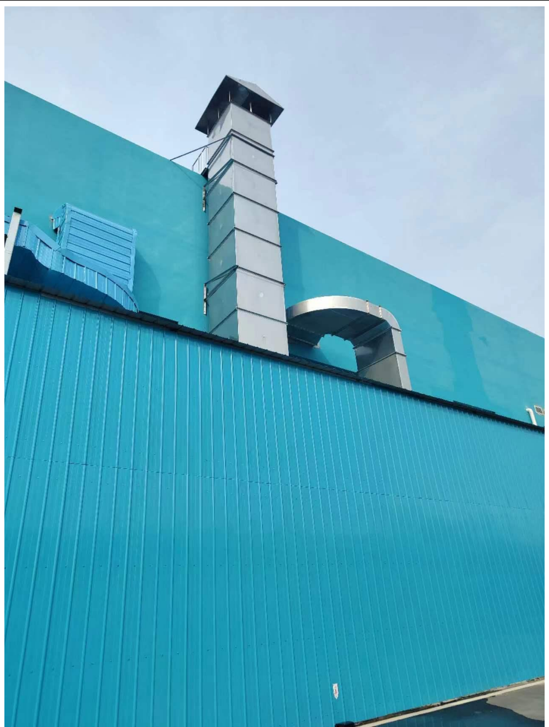
图 3-6 油烟净化器排气筒
