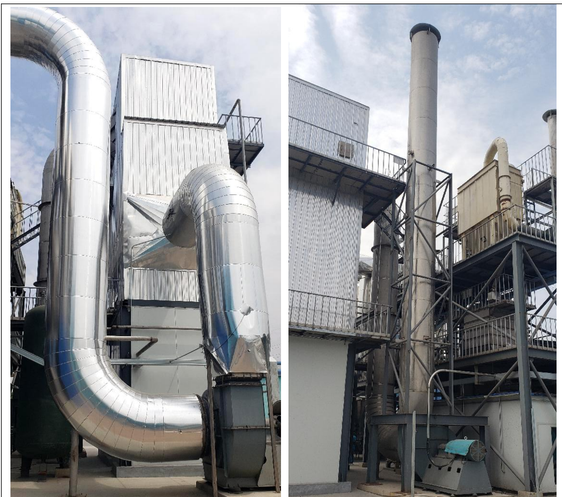
图 3-2 除尘器 and 排气筒
