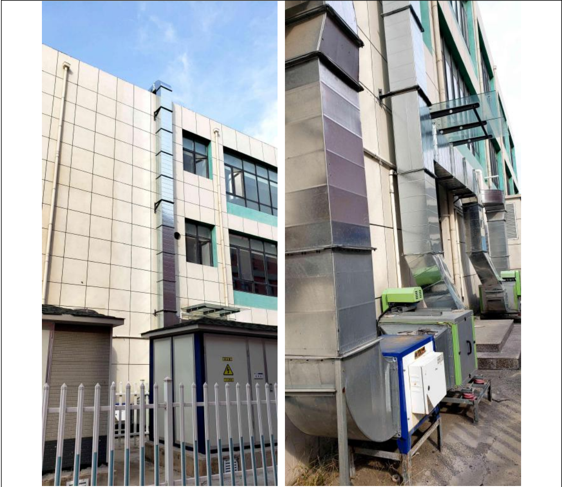
图 3-1 餐厅南侧油烟净化器和排气筒
