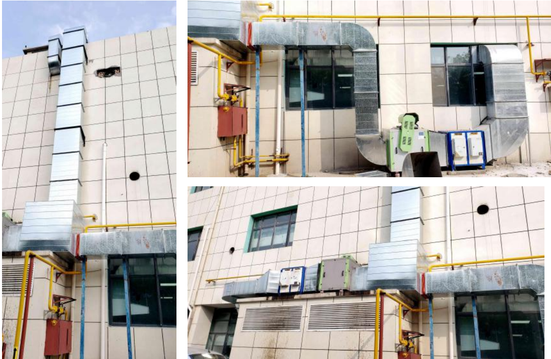
图 3-2 餐厅西侧油烟净化器和排气筒
