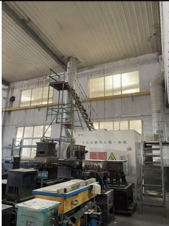
图 3-2 活性炭吸附装置排气管
