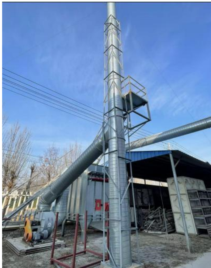
图 3-1 布袋除尘器排气筒
