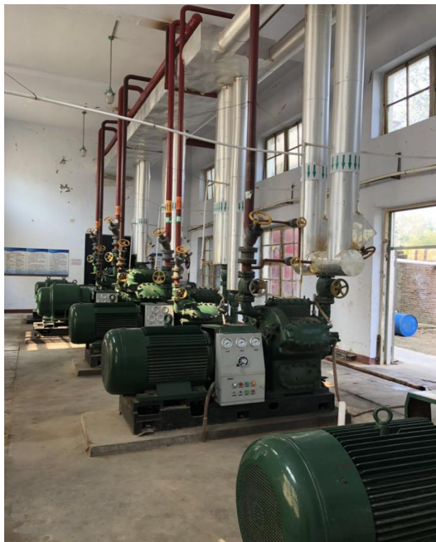
图 4-1 氨气压缩制冷机设备
